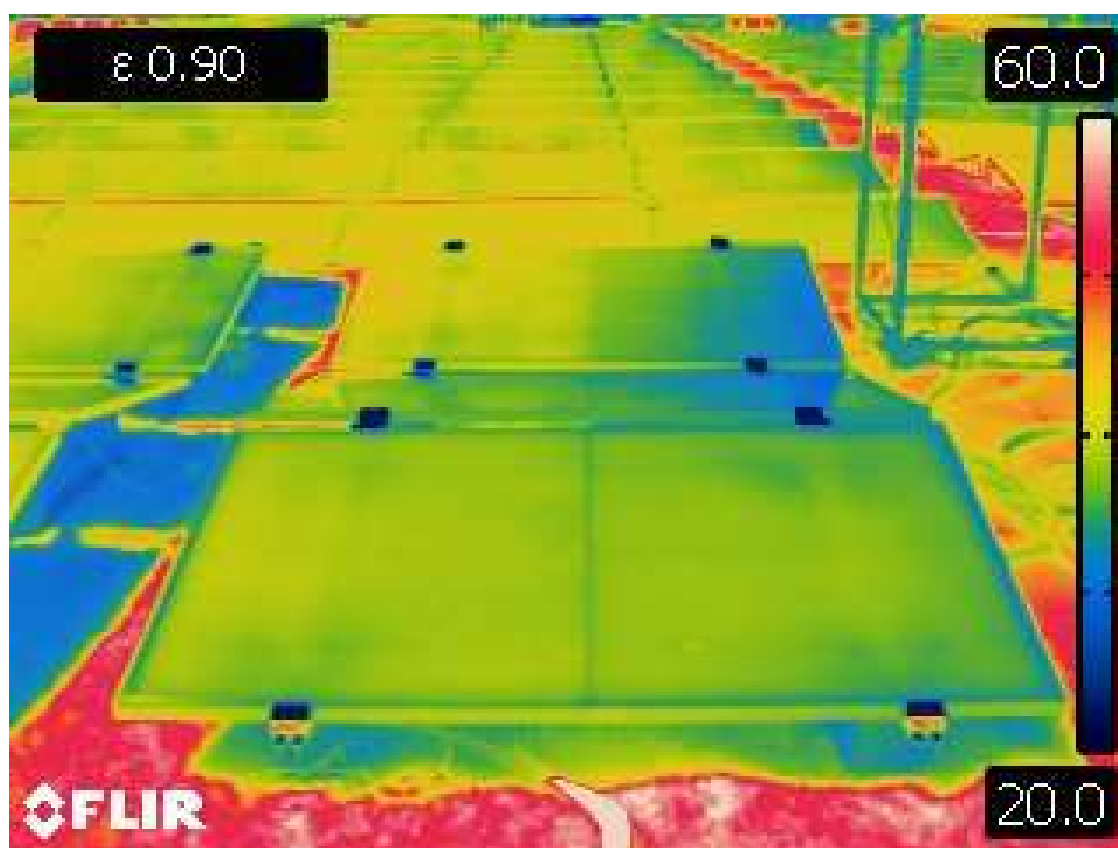
Annexe 13 : Photographie thermique des panneaux PV colorés Alabaster White, en première ligne, et Forest Green, sur la ligne du fond
