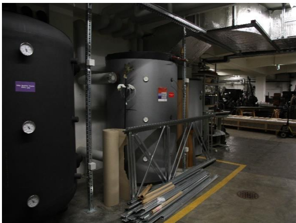
Figure 15 Chaudière du chauffage dans la réserve du sous-sol © He-Arc CR, Gaëtan Guillod, 2022.
