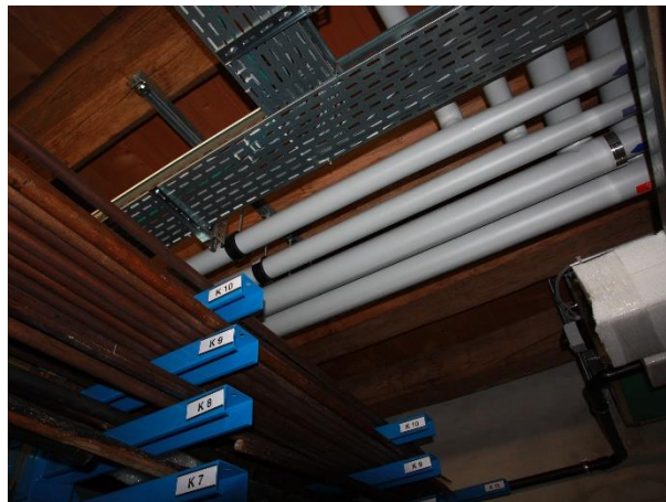
Figure 14 Conduites d'eau situées au-dessus des collections © He-Arc CR, Gaëtan Guillod, 2022.
