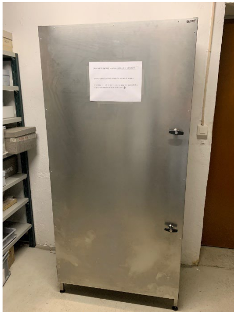
Figure 40 : Armoire climatisée du local métal (transition) à la rue du Pavé 4 (laboratoire de conservation-restauration).
